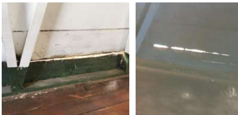
Fig # 5: Condiciones de deterioro de paredes internas y pisos de madera (hendidias y comején).
